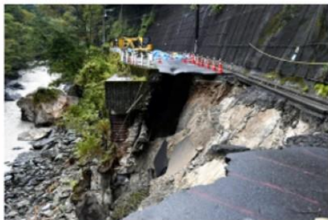
都道204号が崩落した東京都奥多摩町の現場（16日午前）
